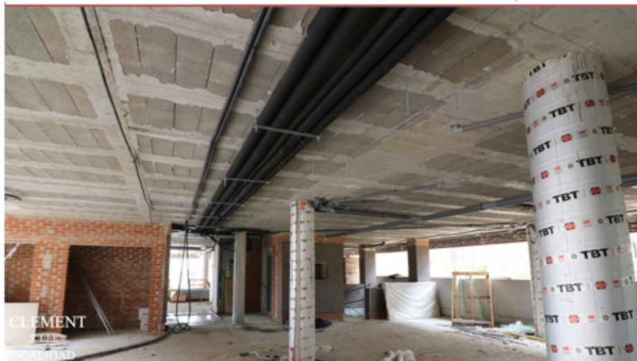
CONDUCTOS DE INSTALACIONES EN TECHO DE PLANTA BAJA
