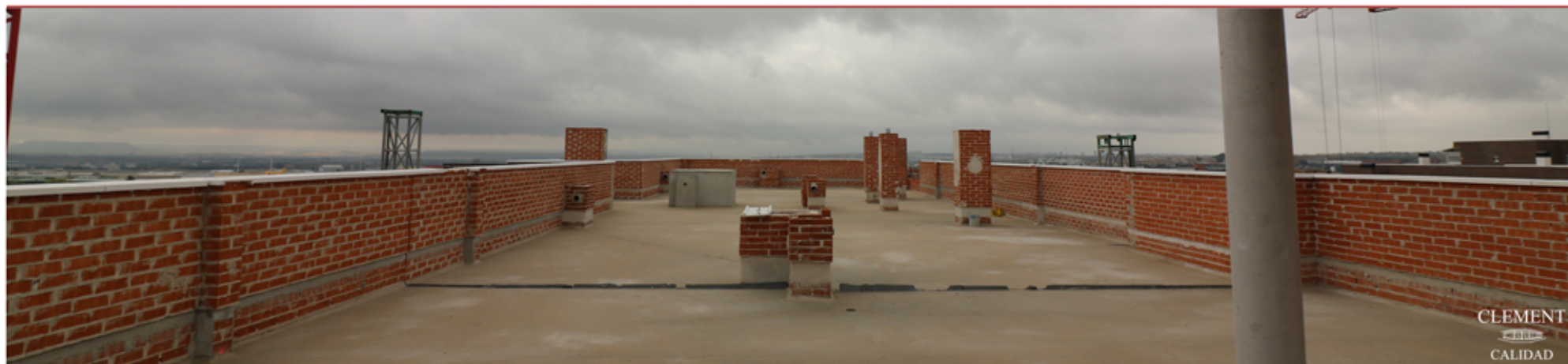
CHIMENEAS DE VENTILACIÓN EN CUBIERTA DE PORTAL I
