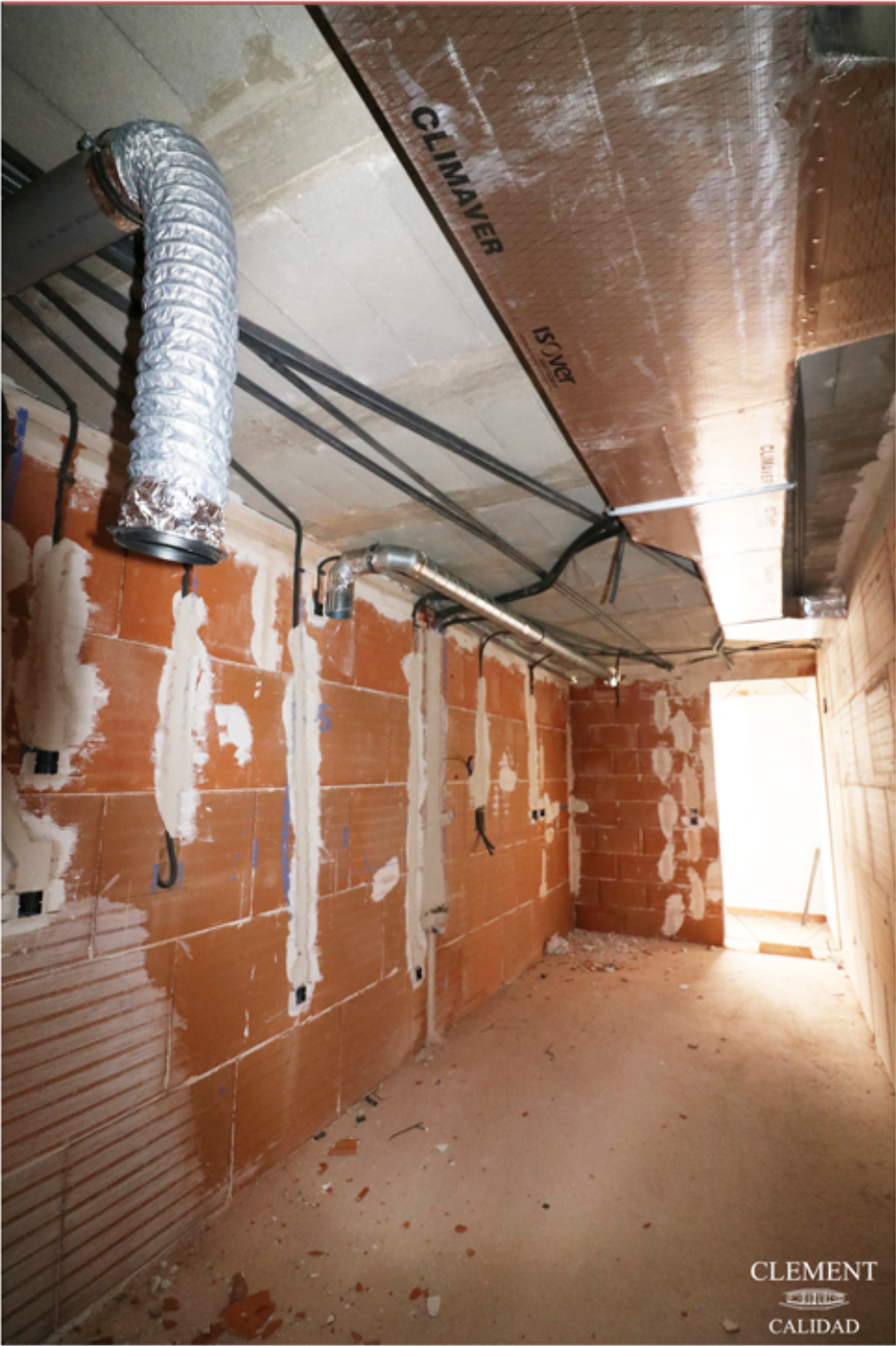
INSTALACIONES DE TODO TIPO EN EL TECHO DE COCINA DE VIVIENDA DE PORTAL 4
