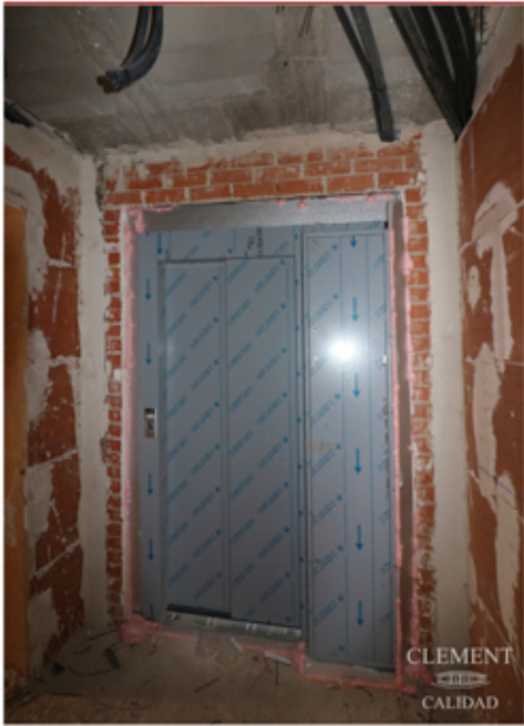
PUERTA DE ASCENSOR INSTALADA
