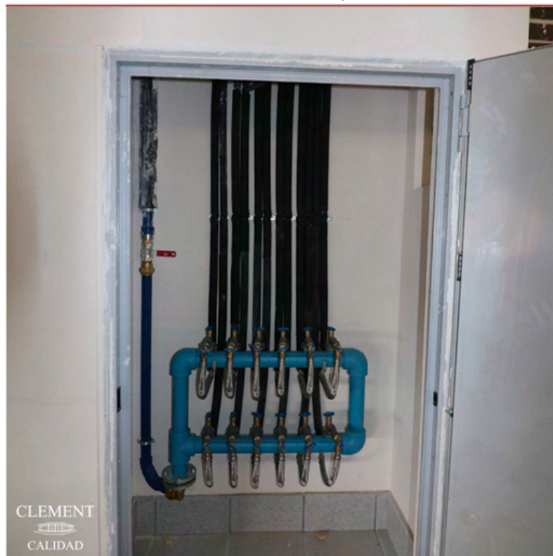
CUARTO TÉCNICO EN PLANTA BAJA EN PORTAL 4
