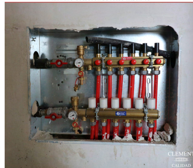
ARMARIO COLECTOR DE SUELO RADIANTE
